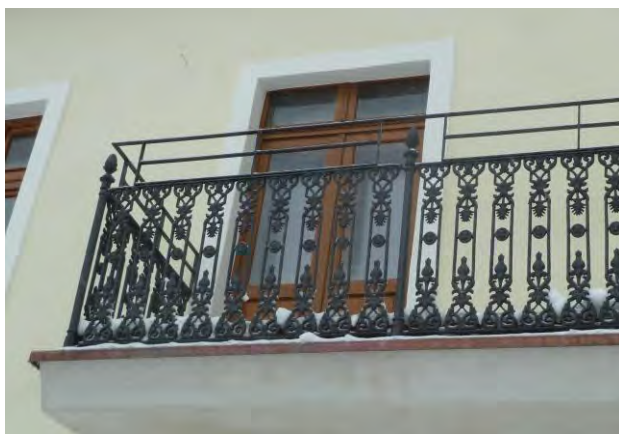
obr. 5: Novotvar madla na historickom zábradlí zdroj: foto autor
