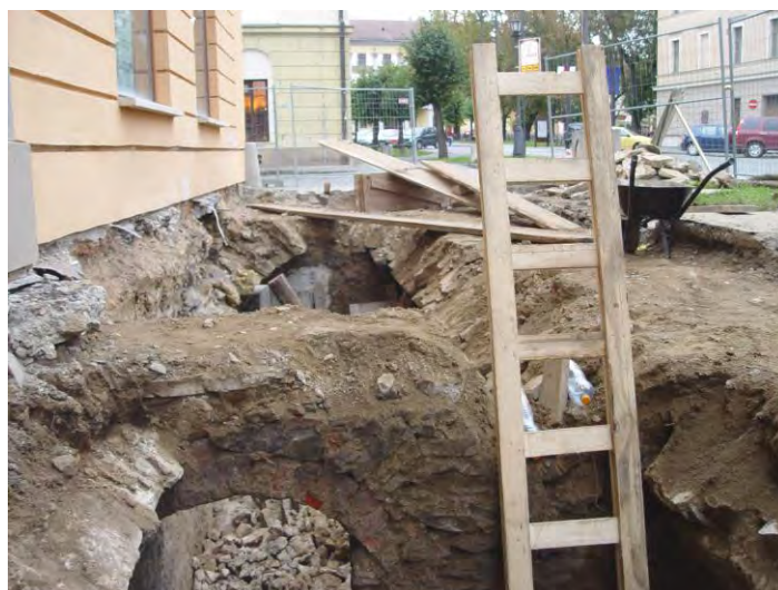
obr. 13: Priebežný pozdĺžny, novoobjavený suterén pod prepádajúcim sa chodníkom objektu NMP č. 53 v Levoči, po deštrukcii klenby, spôsobenej zasekaním elektrických káblov ukladaných do chodníka. Suterén tvoril v minulosti súčasť meštianskeho domu, nachádzal sa pôvodne pod arkádou. zdroj: Janovská M.
