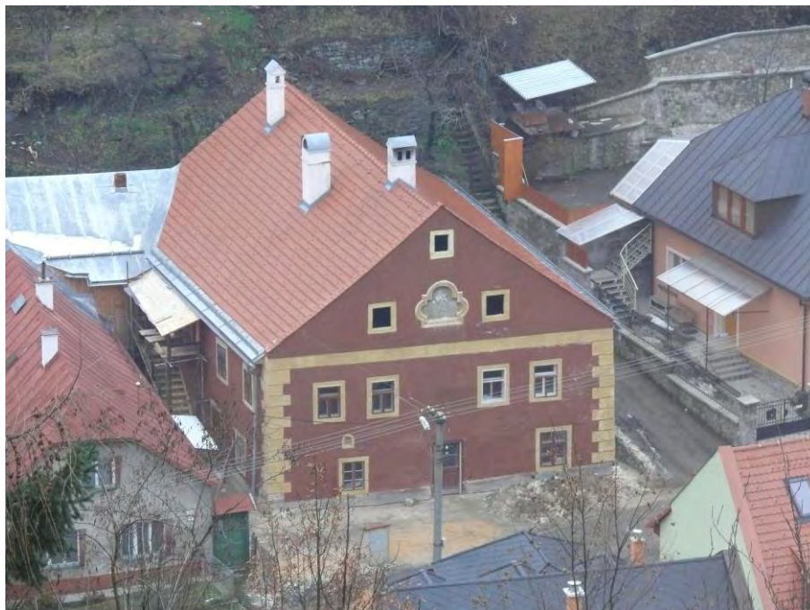
obr. 6: Stav fasád v roku 2007.
