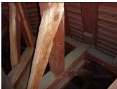
Bratislava - Dóm sv. Martina – pohľad na poslednú obnovu krovu s ležatými stolicami nad svätyňou (rok 2002) – zosekané poškodené časti na povrchu vzpier
