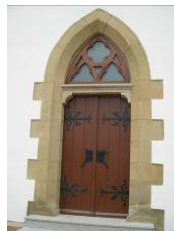
Dolný Kubín, r.k. kostol – dvere do kaplnky južná fasáda – po obnove stav k roku 2009 autor Ing. arch. Karol Ďurian
