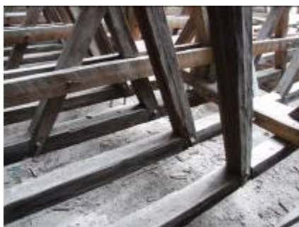
Okoličné – r.kat kostol sv. Petra z Alkantary – obnova krovu z roku 1903 – klieštiny nad väznými trámami
