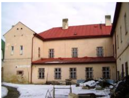
Dvorová fasáda kláštora pred obnovou. Na prízemí prístavby
