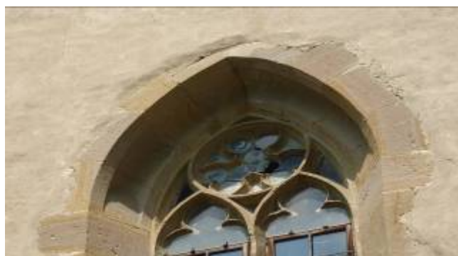
Červený Kláštor, kostol, kamenná kružba okna. P.Glos
